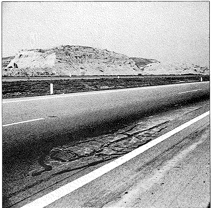
Asiento localizado de la superficie de la calzada que la configura en forma de hundimiento.
