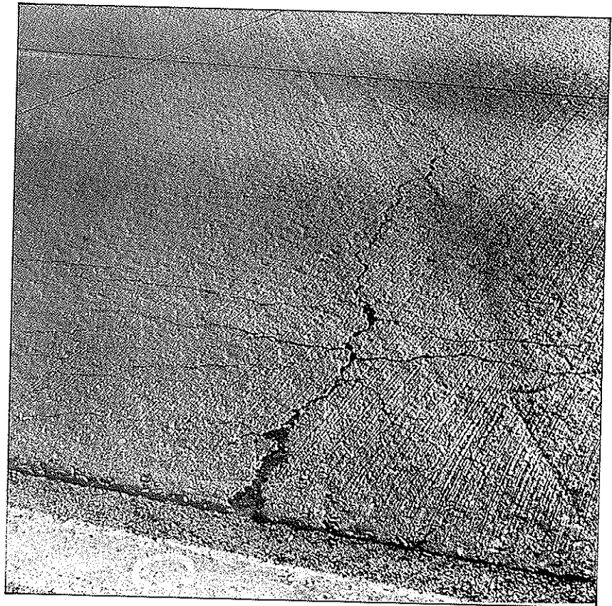
Línea de rotura perpendicular al eje de la calzada.
