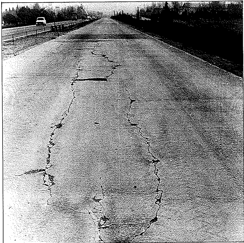
Línea de rotura paralela al eje de la calzada.
