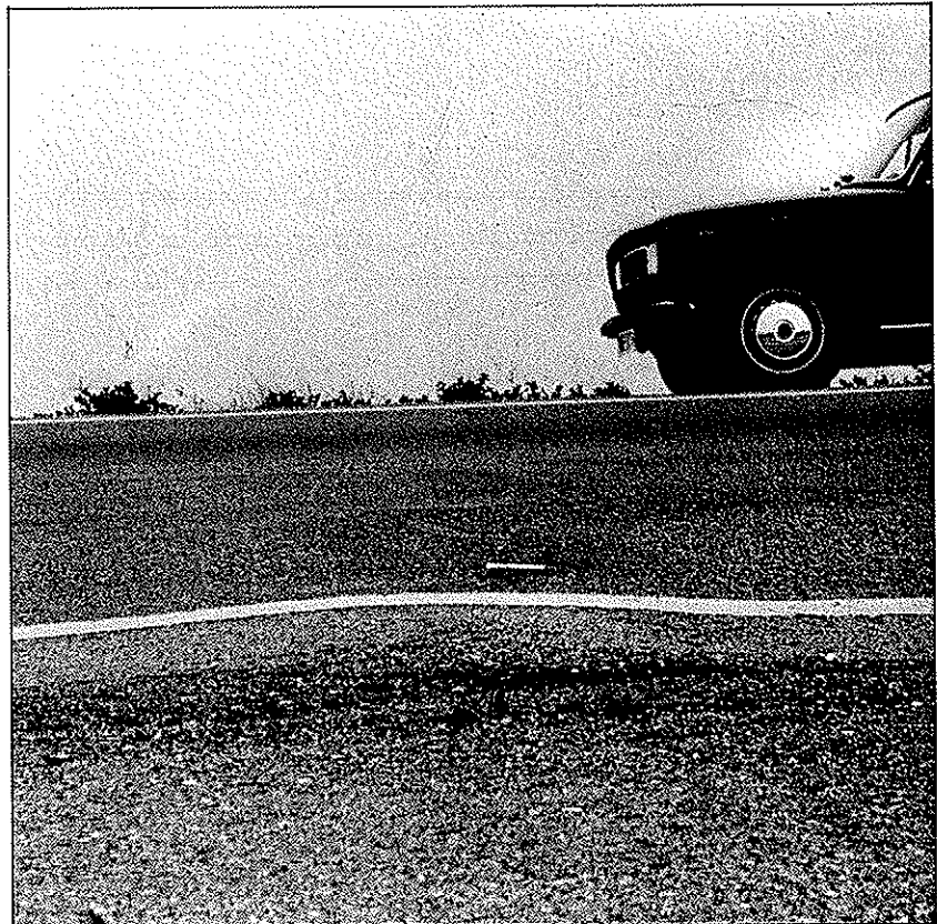
Hinchamiento localizado de la calzada.
