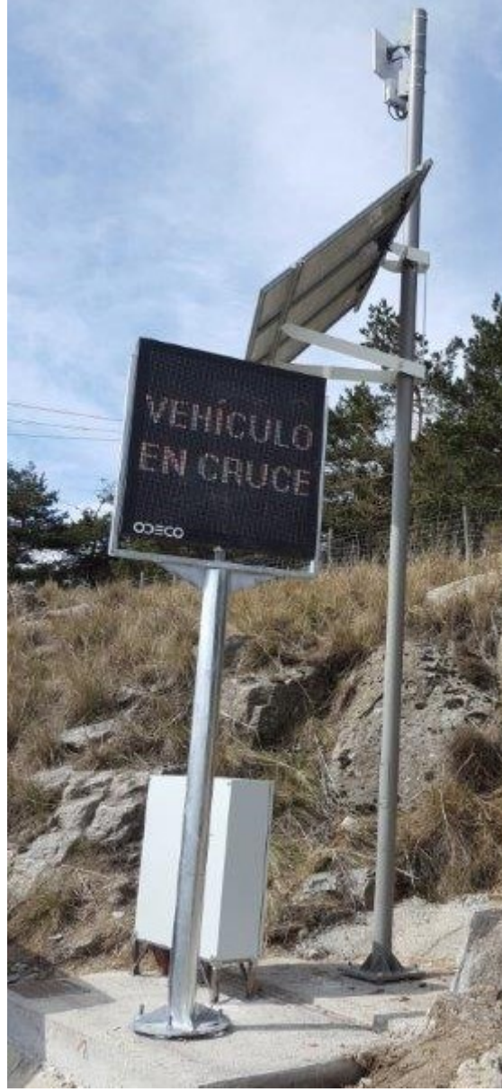
Panel de Mensaje Variable en carretera N-VI pk 57+000.
