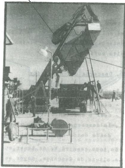
Silo de mezcla
