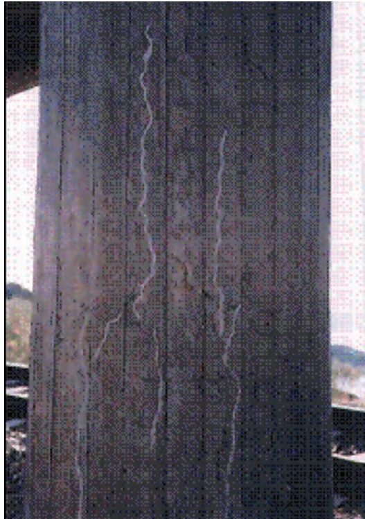
FIGURA 128. FISURACIÓN POR COMPRESIÓN EXCESIVA EN PILAR.
