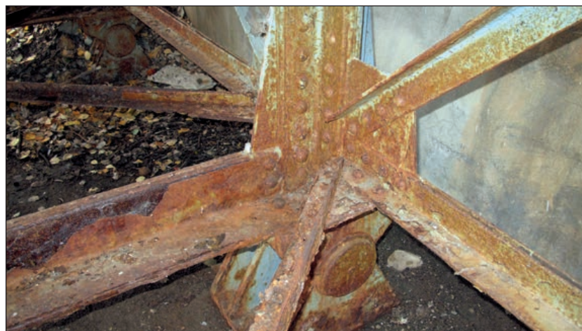
FIGURA 358. CORROSIÓN EN LA ZONA DE UNIONES DE ELEMENTOS.
