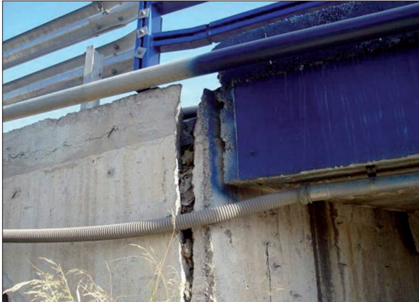
FIGURA 114. GRIETA DE APERTURA ENTRE EL ESTRIBO Y EL MURO LATERAL.
