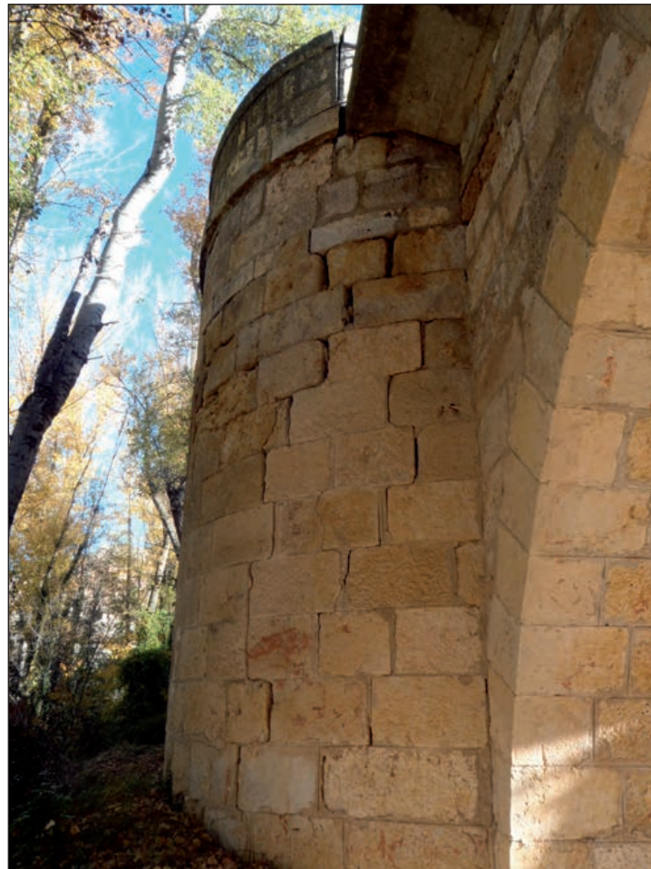
FIGURA 125. FISURACIÓN POR SEPARACIÓN DEL TAJAMAR (AGUAS ABAJO) DE LA PILA.
