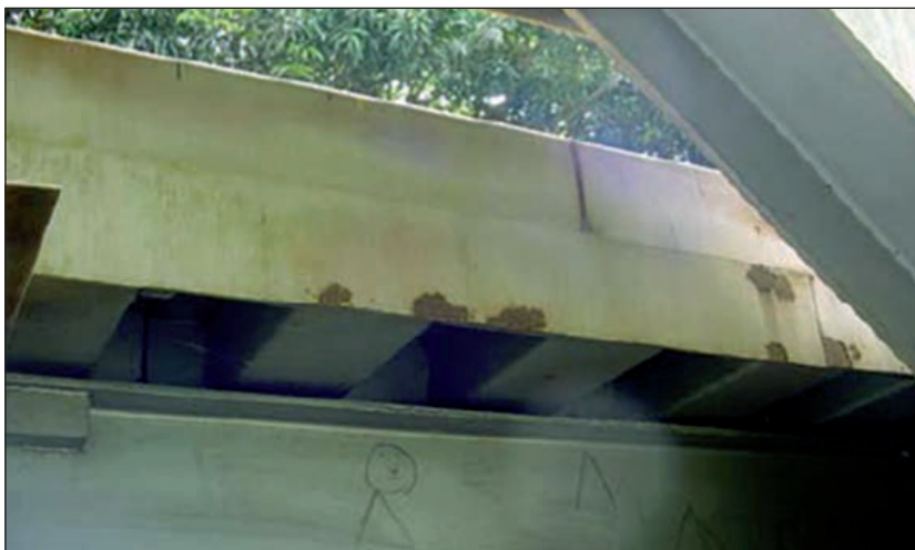
FIGURA 359. CORROSIÓN LEVE EN UNA VIGA.
