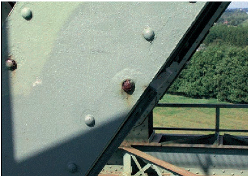
FIGURA 356. ROBLONES AFECTADOS POR LA CORROSIÓN.
