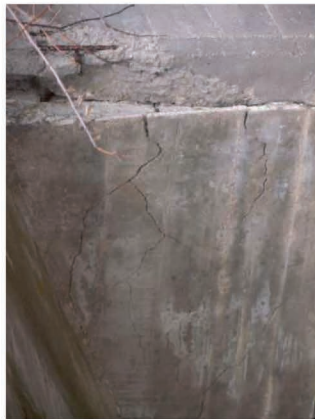
Fot4 Fisuras/Grietas Lib.8
