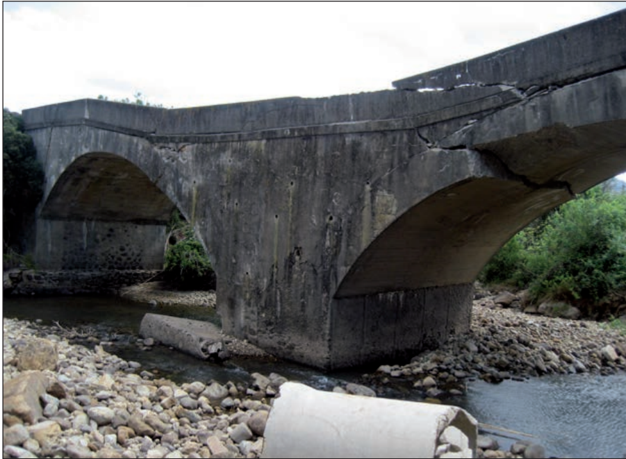
FIGURA 123. EFECTO DEL GIRO DE PILA EN UNA BÓVEDA.
