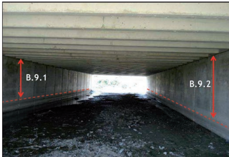
FIGURA 3.9.1. EVIDENCIA DE UN NIVEL MÁXIMO DEL AGUA EN LOS ESTRIBOS.
