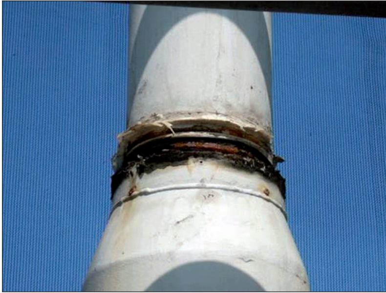
FIGURA 213. CORROSIÓN EN EL ANILLO DE CONEXIÓN TUBO ANTIVANDÁLICO-VAINA.
