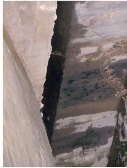
Fot4 Vegetación en dintel cargadero Lib.1
