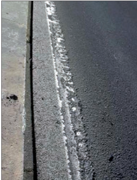
FIGURA 283. ENVEJECIMIENTO DE LA PINTURA DE SEÑALIZACIÓN HORIZONTAL.
