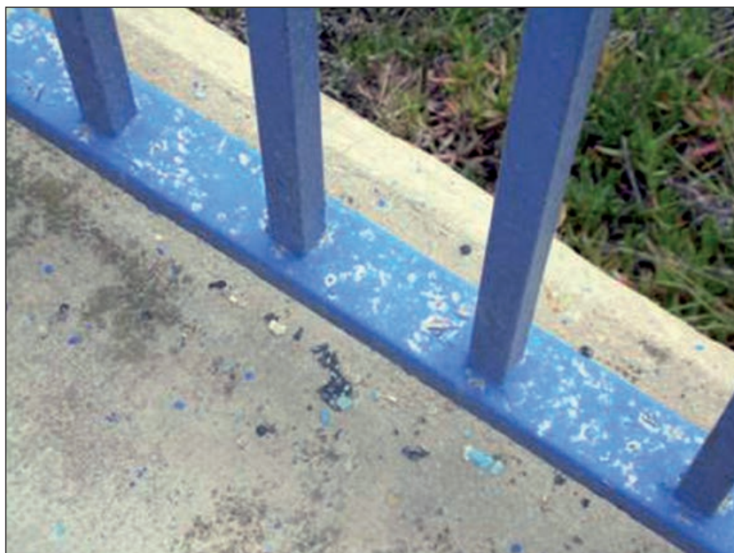
FIGURA 274. PÉRDIDA DE PINTURA EN BARANDILLA.
