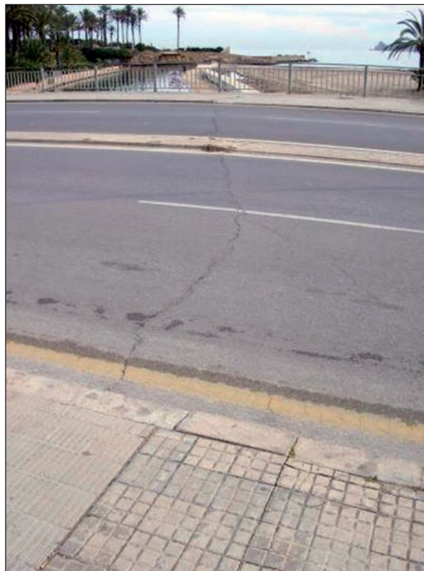
FIGURA 259. GRIETAS TRANSVERSALES EN PAVIMENTO DEBIDO A EFECTOS TÉRMICOS.
