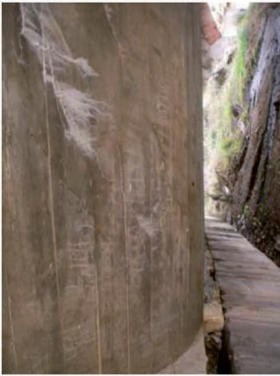
Fot2 Fisuras/Grietas Lib.904
