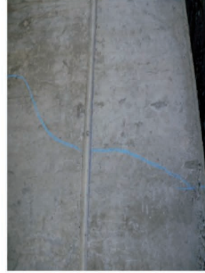
Det.5. Fis. Grietas.Lib.905
