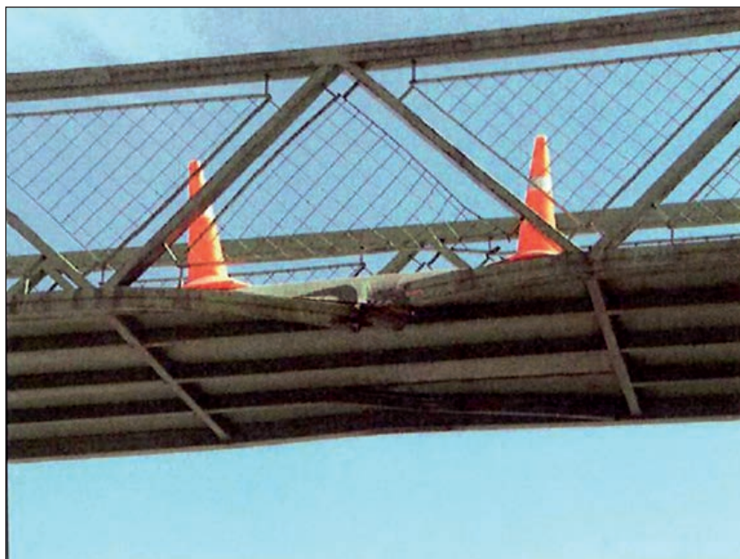
FIGURA 164. ROTURA DEL CORDÓN INFERIOR DE VIGA METÁLICA DEBIDO AL IMPACTO DE UN VEHÍCULO.
