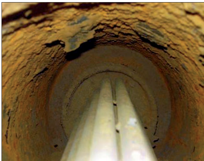
FIGURA 209. CORROSIÓN DE LA CARA INTERIOR DE TUBO DE ENCOFRADO NO GALVANIZADO.
