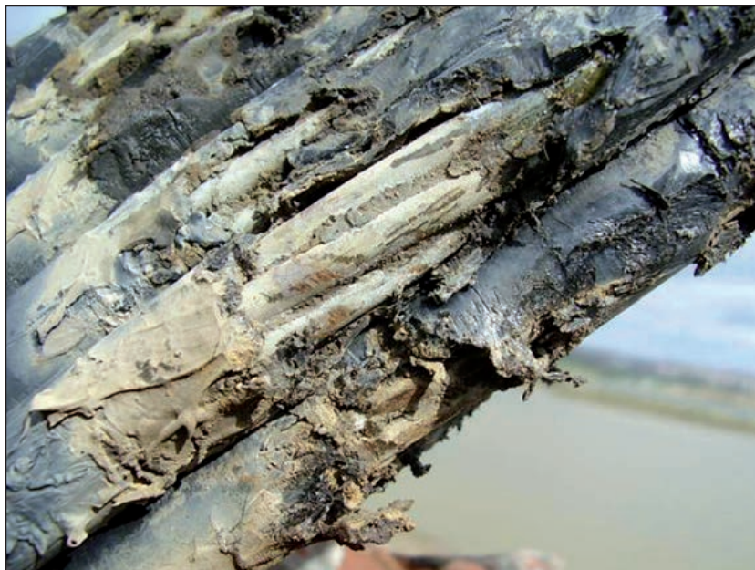
FIGURA 206. VAINA DE CORDÓN DAÑADA POR IMPACTO, DAÑO AL TUBO ANTIVANDALISMO Y POSTERIOR ROCE.
