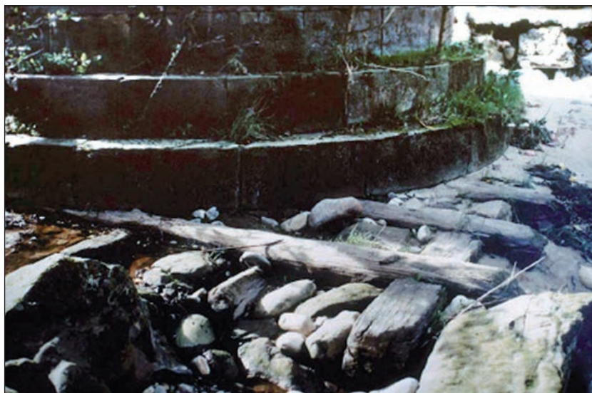
FIGURA 100. ENCEPADO DE PILOTES DE MADERA DESGUARNECIDO.
