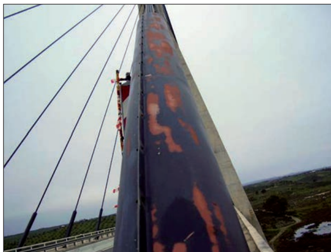
FIGURA 212. EROSIÓN DE PINTURA EN TUBO ANTIVANDÁLICO POR PROYECCIÓN DESDE LA CALZADA.
