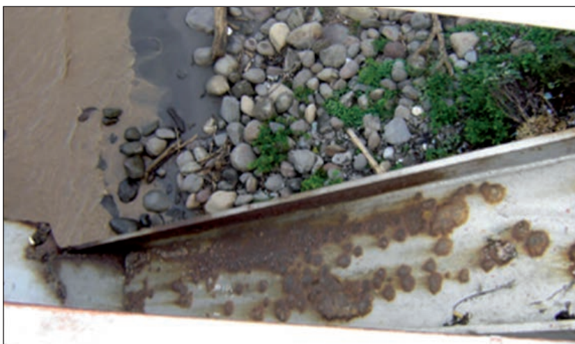
FIGURA 360. CORROSIÓN MEDIA EN UNA DIAGONAL.
