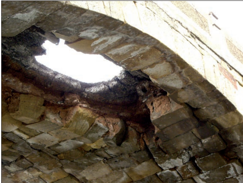
FIGURA 183. ROTURA POR CARGA PUNTUAL EXCESIVA CON FALTA DE RELLENO EN CLAVE.
