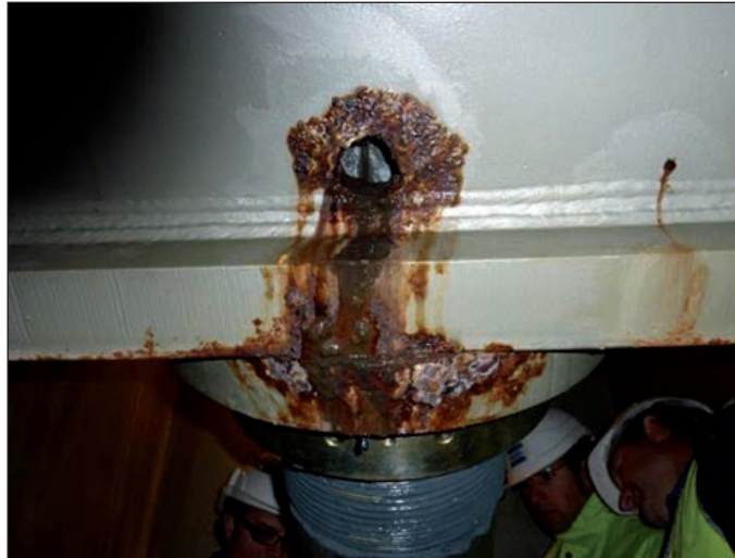
FIGURA 210. PURGAS DE TUBO DE ENCOFRADO CON PRESENCIA DE CORROSIÓN.
