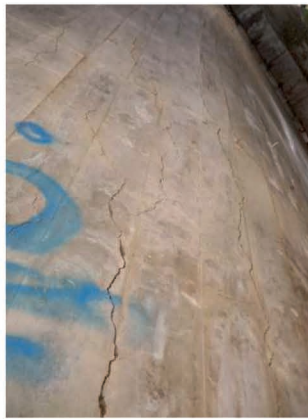
Fot5 Fisuras/Grietas Lib.903
