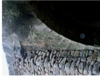
Fot7 Humedades y filtraciones Lib.4
