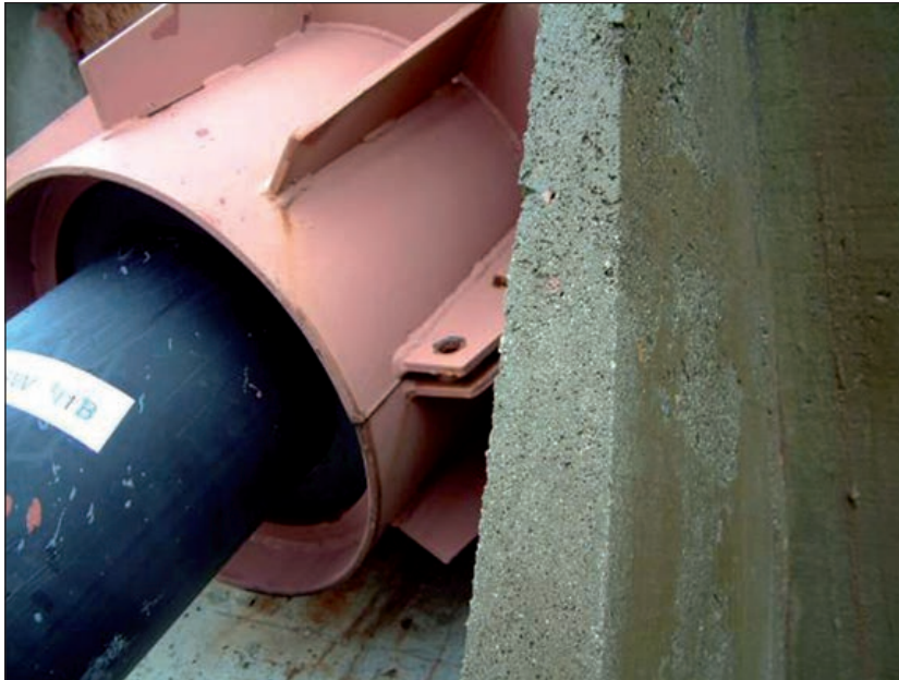
FIGURA 226. AUSENCIA DE PERNOS DE ANCLAJE EN UN ANILLO CENTRADOR.
