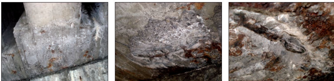
FIGURAS 324, 325 Y 326. ASPECTO DE LOS DAÑOS Y ESTADO DE LA ARMADURA AFECTADA POR CORROSIÓN EN UN APOYO DE UN NERVIÓ DE UN TABLERO CON SALES FUNDENTES.
