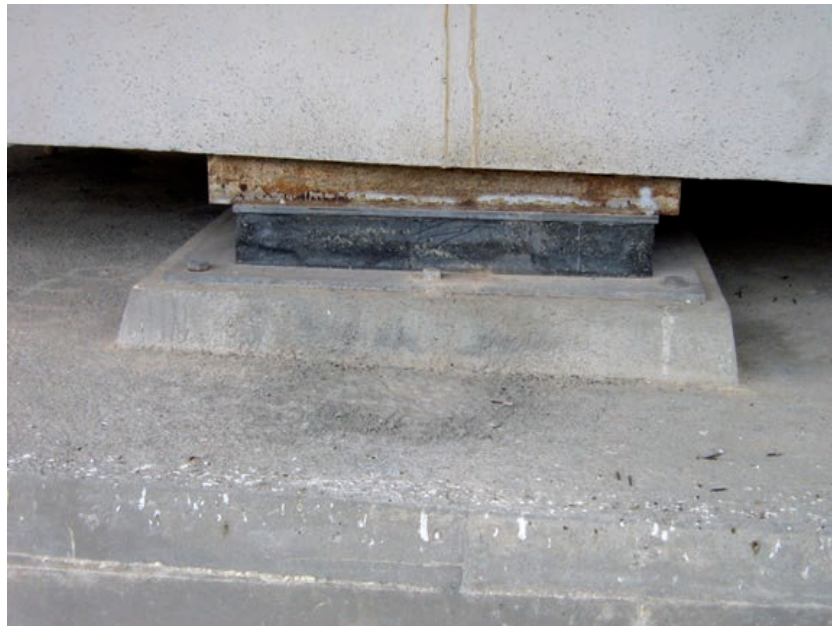
FIGURA 86. FOTOGRAFÍA DE APOYO ELASTOMÉRICO ANCLADO EN VIADUCTO.
