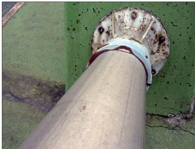
FIGURA 211. CORROSIÓN EN LA BRIDA DE CONEXIÓN DEL TUBO GUÍA AL TABLERO.
