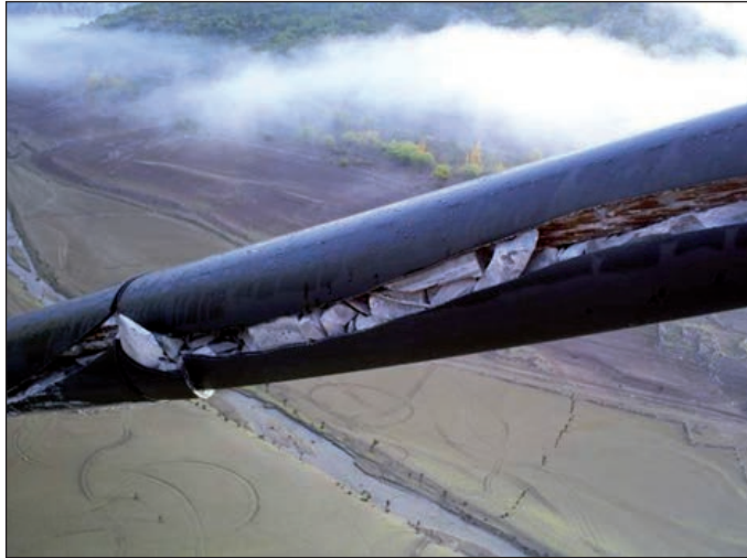
FIGURA 207. DAÑO EN CORDONES POR CONTACTO CON TUBO DE ENCOFRADO.
