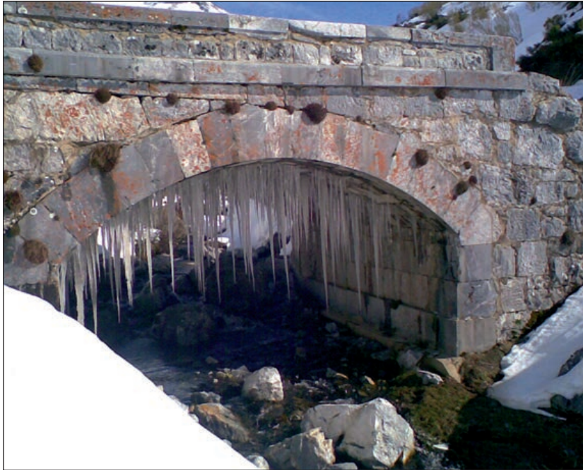
FIGURA 353. FILTRACIONES A TRAVÉS DE LA BÓVEDA DEBIDO A UNA INADECUADA IMPERMEABILIZACIÓN.
