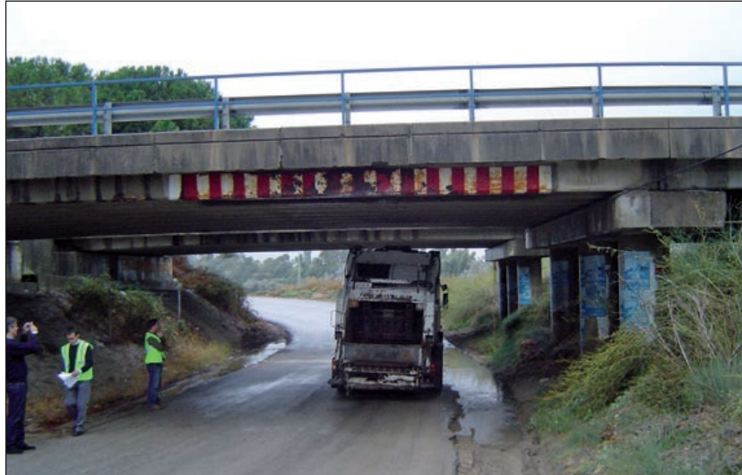
FIGURA 75. ESTRUCTURA CON PROBLEMAS DE GÁLIBO.
