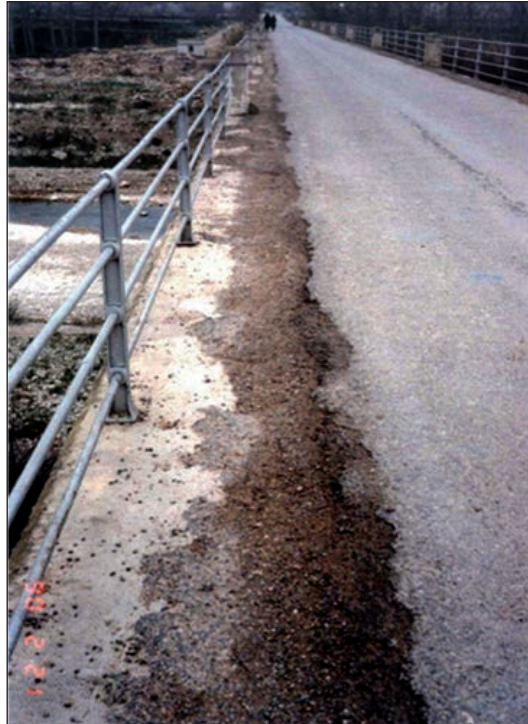
FIGURA 343. EJEMPLO DE REPAVIMENTACIÓN SIN FRESADO PREVIO
