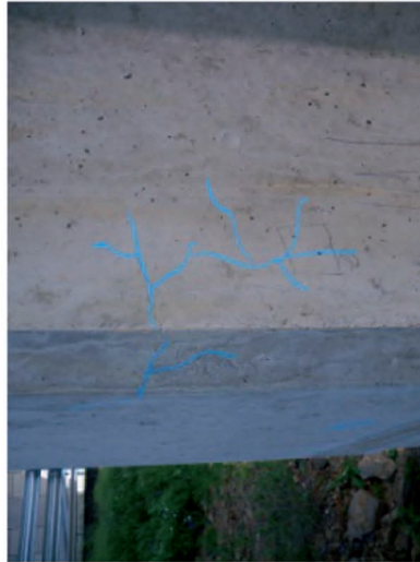
Det.2. Fis/Grietas. Lib.13.
