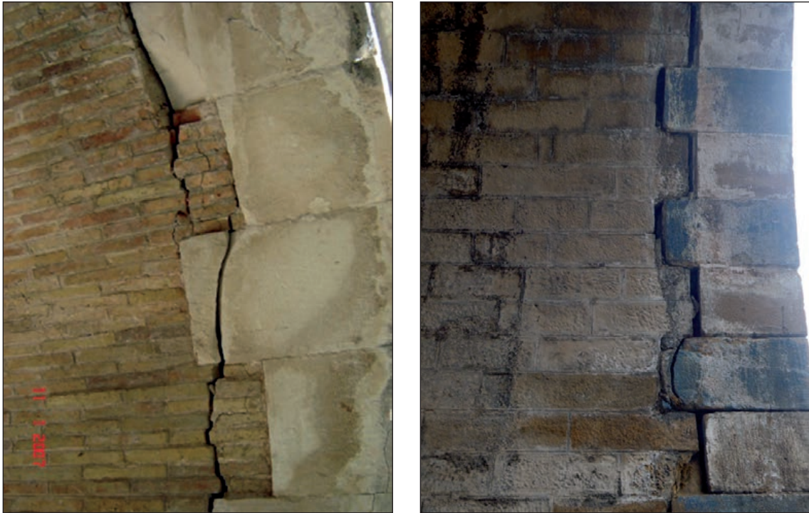
FIGURAS 172 Y 173. GRIETA DE SEPARACIÓN ENTRE BÓVEDA Y BOQUILLA.
