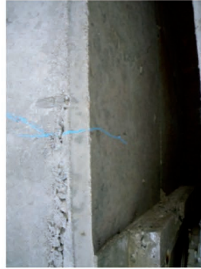
Det.5. Fis. Grietas. Lib.905
