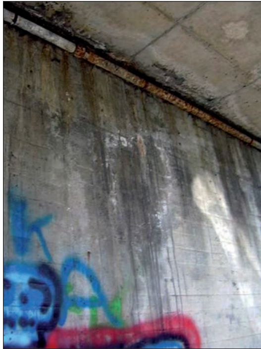
FIGURA 347. HUMEDADES EN EL ESTRIBO DEBIDO A LA FALTA DE ESTANQUEIDAD DE LA JUNTA DE CALZADA.
