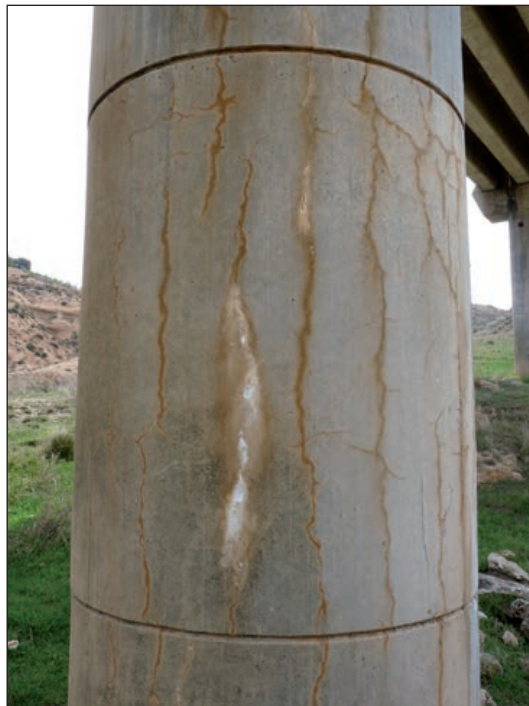
FIGURA 329. FISURAS POR CORROSIÓN DE ARMADURAS EN PILA.
