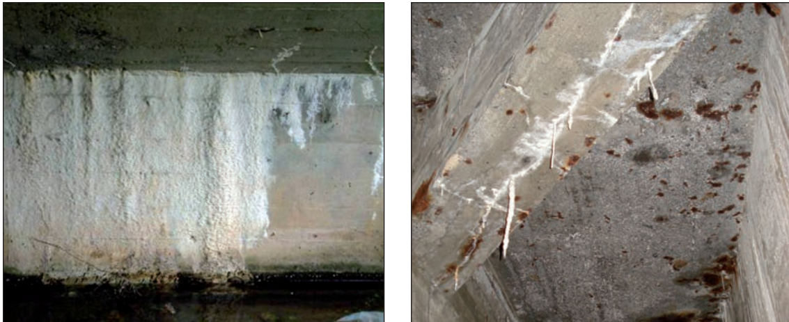
FIGURAS 296 Y 297. EFLORESCENCIAS EN ESTRIBO Y EN LA CARA INFERIOR DE UNA LOSA NERVADA.
