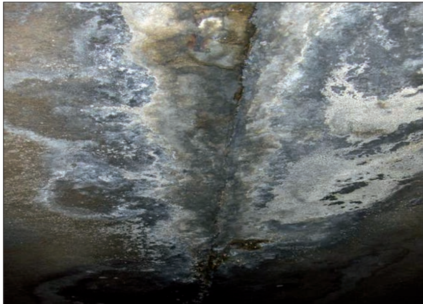
FIGURA 298. EFLORESCENCIAS EN UNA ZONA DE JUNTA, EN LA CARA INFERIOR DE UN TABLERO.
