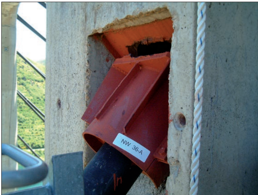
FIGURA 227. SOLDADURA ROTA ENTRE ANILLO CENTRADOR Y PLACA DE ANCLAJE.
