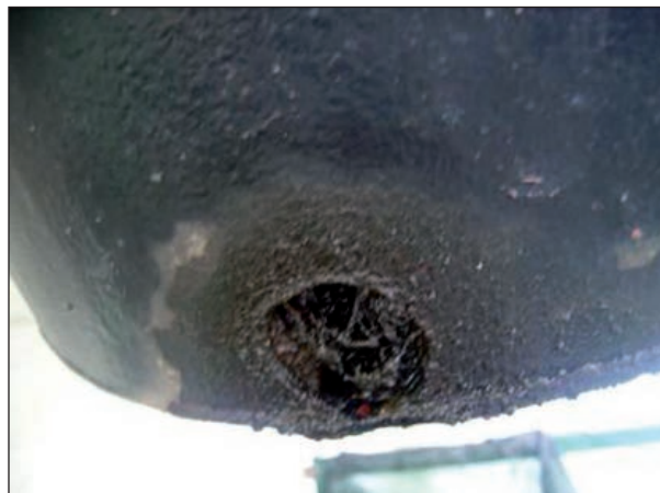
FIGURA 218. PRESENCIA DE AGUA EN CAPOT DE PROTECCIÓN DE ANCLAJE.
