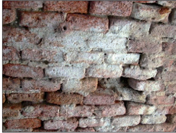
FIGURA 351. EFLORESCENCIAS EN FÁBRICA DE LADRILLO.
