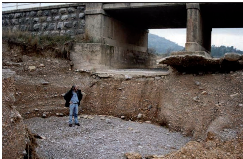
FIGURA 94. SOCAVACIÓN EN PILA.
