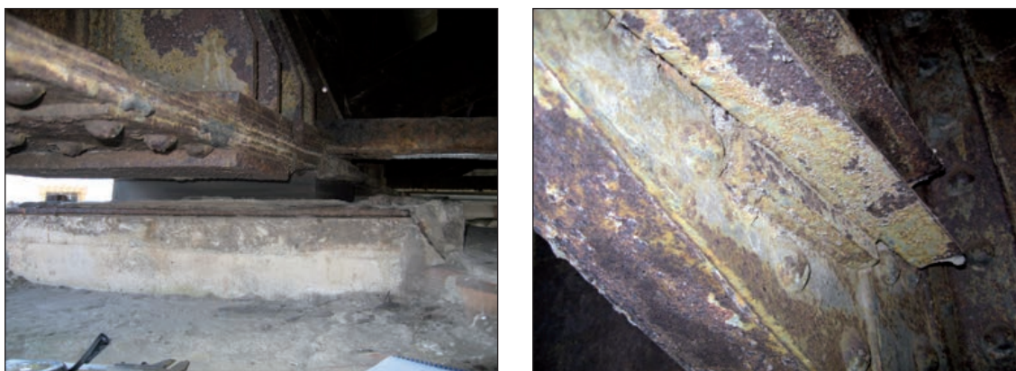
FIGURAS 365 Y 366. CORROSIÓN EN UNIONES ROBLONADAS.
