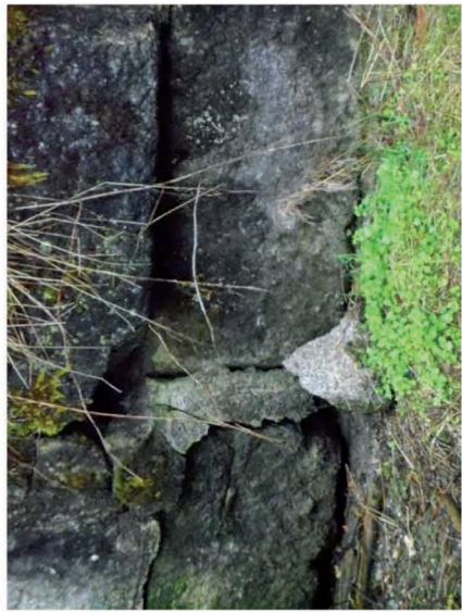
Fot1 Fragmentación (pérdida de sección en los sillares) Lib3
