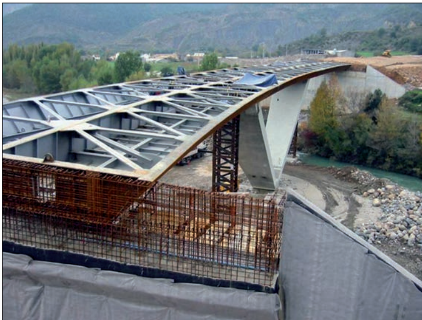
FIGURA 167. DETALLE DE LA SECCIÓN TRANSVERSAL DE UN CAJÓN.
