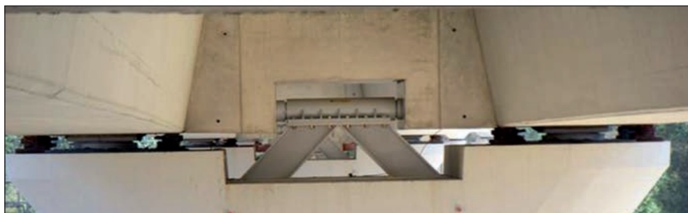
FIGURA 91. DISPOSITIVO DEPENDIENTE DE LA VELOCIDAD (Fuente: Conservación de aparatos de apoyo, juntas y drenaje en puentes; ACHE-ATC; 2011).
