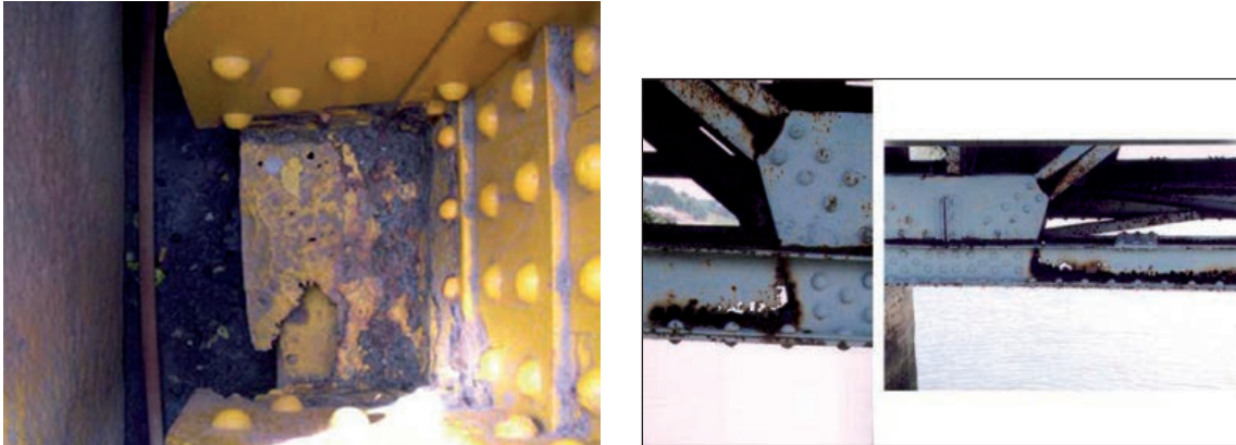
FIGURAS 361 Y 362. CORROSIÓN SEVERA CON PÉRDIDAS DE SECCIÓN DE LAS CHAPAS.
