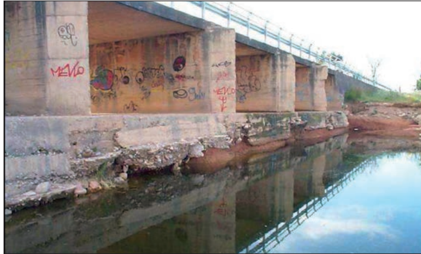
FIGURA 2.14.3. PROTECCIÓN DEL LECHO EN MALAS CONDICIONES (DAÑOS GRAVES).
