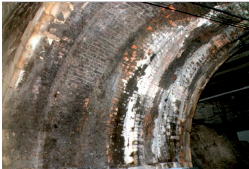
FIGURA 186. HUMEDADES Y EFLORESCENCIAS EN BÓVEDA DE FÁBRICA DE LADRILLO.
