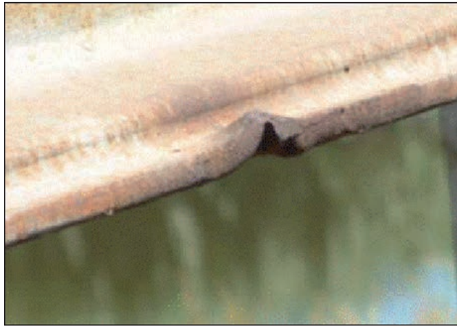
FIGURA 166. ENTALLA EN EL ALA INFERIOR DE UNA VIGA METÁLICA.
