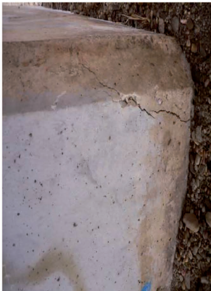
Fot2 Fisuras/Grietas Lib.1
