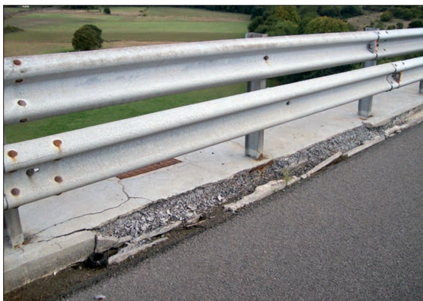
FIGURA 294. DETALLE DE LA DEGRADACIÓN DEL HORMIGÓN EN ACERAS POR EFECTO DE HIELO-DESHIELO: ZONAS CON INTENSA VIALIDAD INVERNAL.
