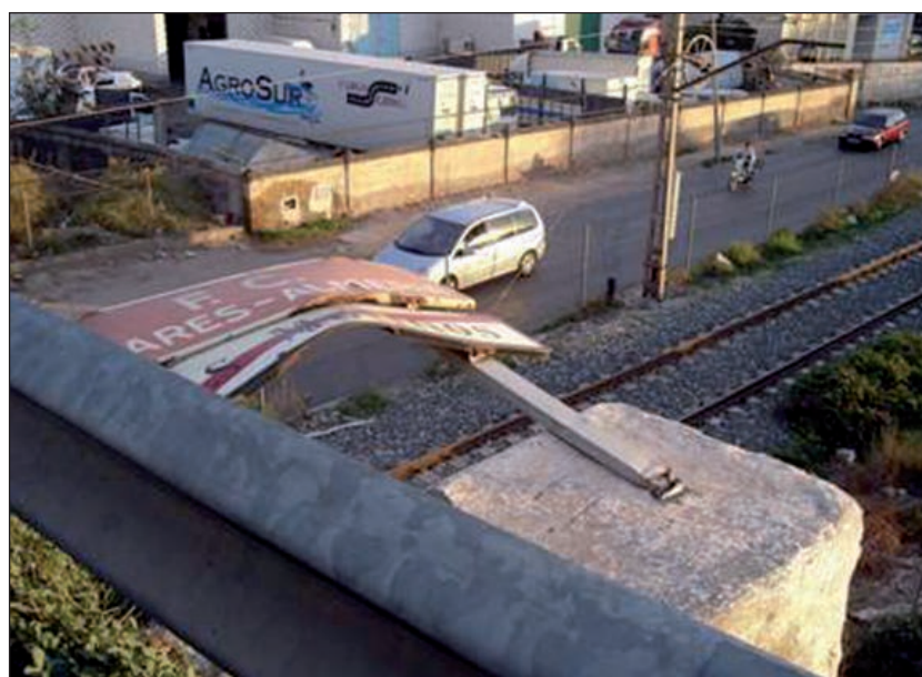
FIGURA 282. ROTURA DE SEÑALIZACIÓN VERTICAL.
