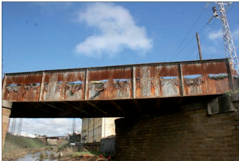
FIGURA 323. CORROSIÓN INTENSA DE UN TABLERO METÁLICO.
