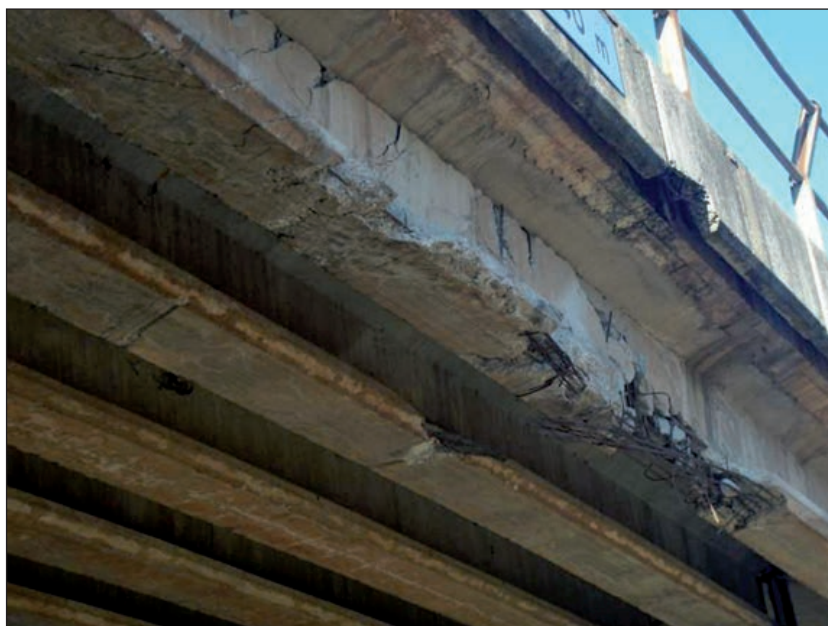
FIGURA 284. TABLERO DE HORMIGÓN DAÑADO POR EL IMPACTO DE UN VEHÍCULO.
