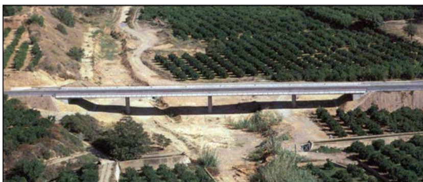
FIGURAS 2.5.2 Y 2.5.3. VISTA DE UN EFECTO BARRERA DEL TERRAPLÉN DE ACCESO A UN PUENTE.
