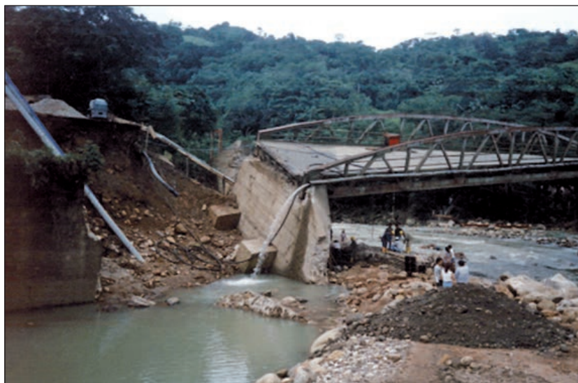
FIGURA 109. GIRO DEL ESTRIBO SEGÚN SU EJE LONGITUDINAL HASTA COLAPSO DE LA ESTRUCTURA.
