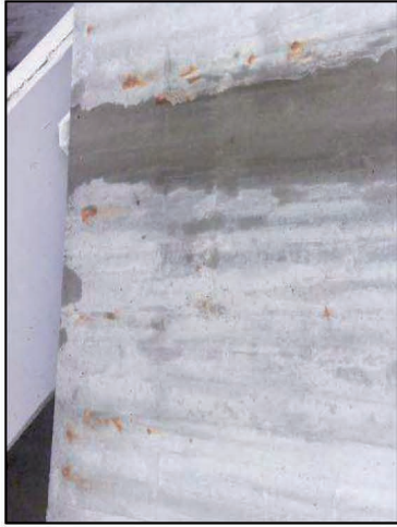
Fot.8. Escasez de recubrimiento en M.Frontal (lib. 1)
