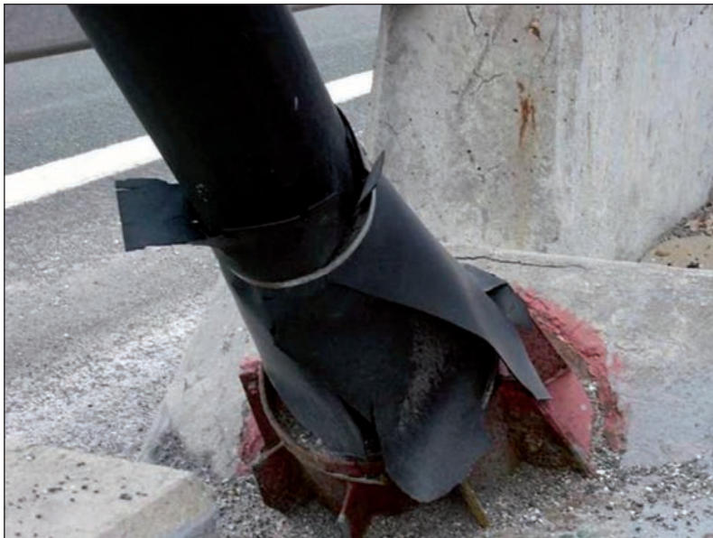
FIGURA 214. DAÑOS EN FALDÓN DE CONEXIÓN ENTRE VAINA Y TUBO GUÍA.
