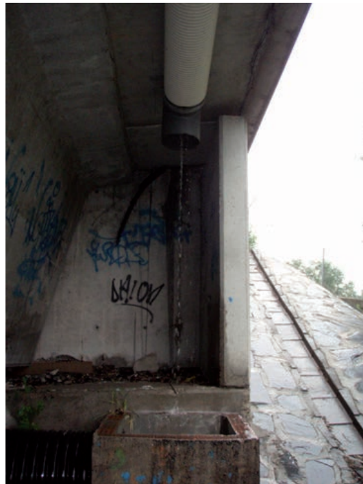
FIGURA 271. TUBO DE DESAGÜE DE LONGITUD INSUFICIENTE (EL AGUA CAE DIRECTAMENTE SOBRE EL BORDE DE LA ARQUETA, PROVOCANDO SALPICADURAS ALREDEDOR).
