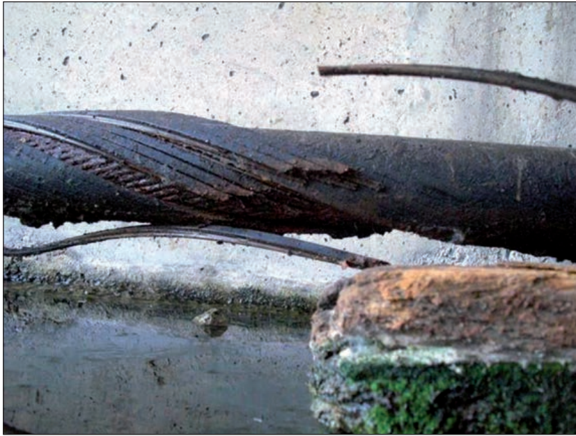
FIGURA 219. ROTURA DE HILOS PERIFÉRICOS SIN REANCLADO.
