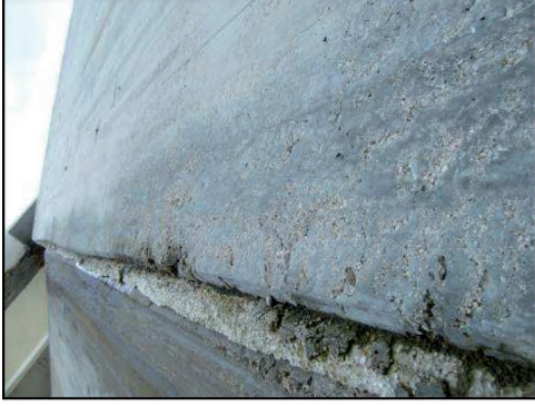
Fot.9. Degradación superficial del M.lat. (lib.4)
