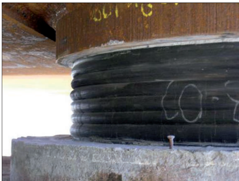
FIGURA 232. EXCESO DE COMPRESIÓN EN UN APARATO DE APOYO.
