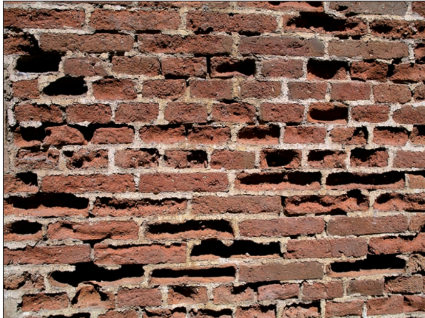
FIGURA 354. EXFOLIACIONES AVANZADAS EN FÁBRICA DE LADRILLO.
