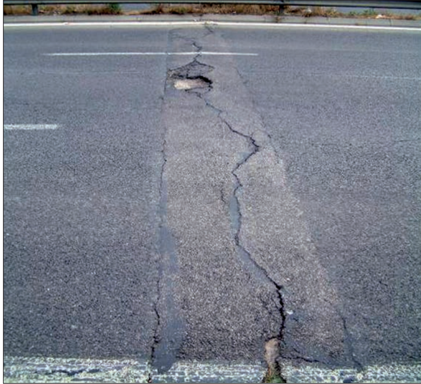
FIGURA 250. ROTURA DE UNA JUNTA DE BETÚN MODIFICADO.
