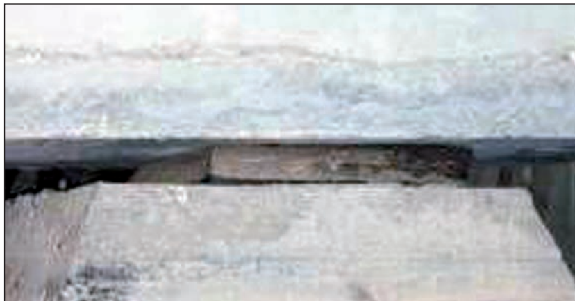
FIGURA 235. PRESENCIA DE MANCHAS SUPERFICIALES EN EL APARATO DE APOYO.
