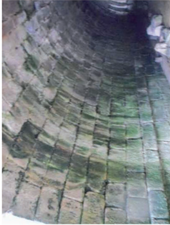
Fot4 Humedades y filtraciones Lib.7
