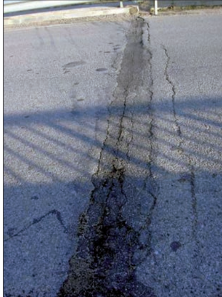
FIGURA 246. DEGRADACIÓN MUY AVANZADA DE JUNTA DE CALZADA DE BETÚN MODIFICADO.
