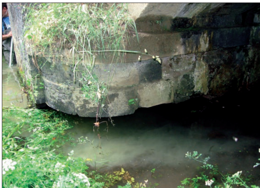
FIGURA 93. PÉRDIDA DE SILLARES EN PIE DE PILA.
