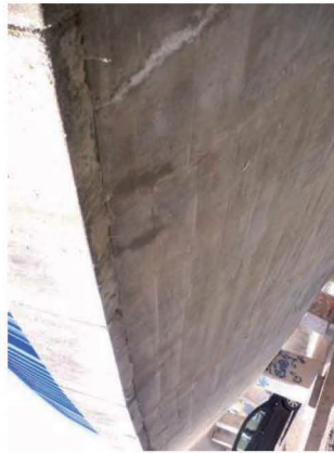
Fot6 Humedades y filtraciones Lib.4
