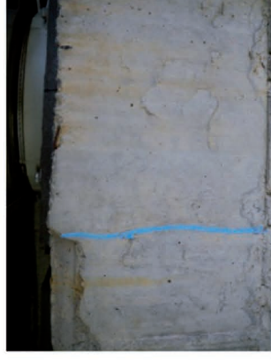
Det.4. Fis./Grietas. Lib. 7.
