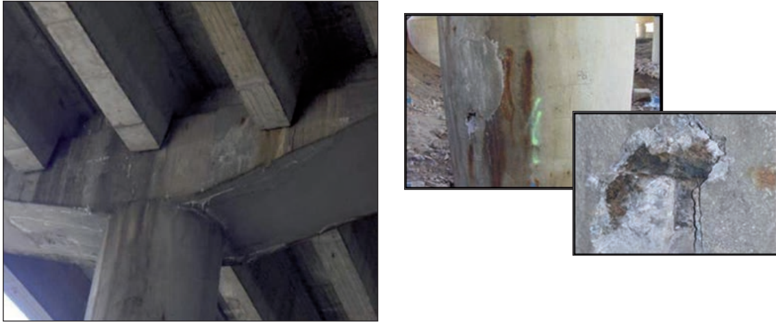
FIGURAS 320, 321 Y 322. EFECTOS DE LA CORROSIÓN POR CLORUROS EN UNA PILA CON SALES FUNDENTES.
