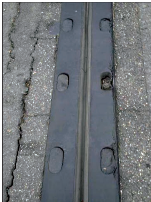
FIGURA 254. FALTA DE ELEMENTOS PROTECTORES DE ANCLAJES DE LA JUNTA.
