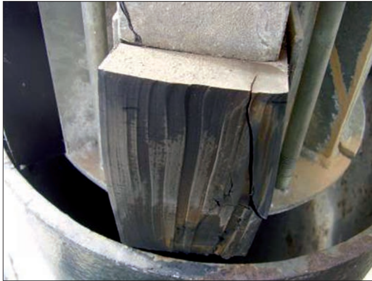
FIGURA 223. PISTONES DE ELASTÓMEROS REPTADOS FUERA DEL TUBO DE ENCOFRADO POR OSCILACIONES DEL TIRANTE.
