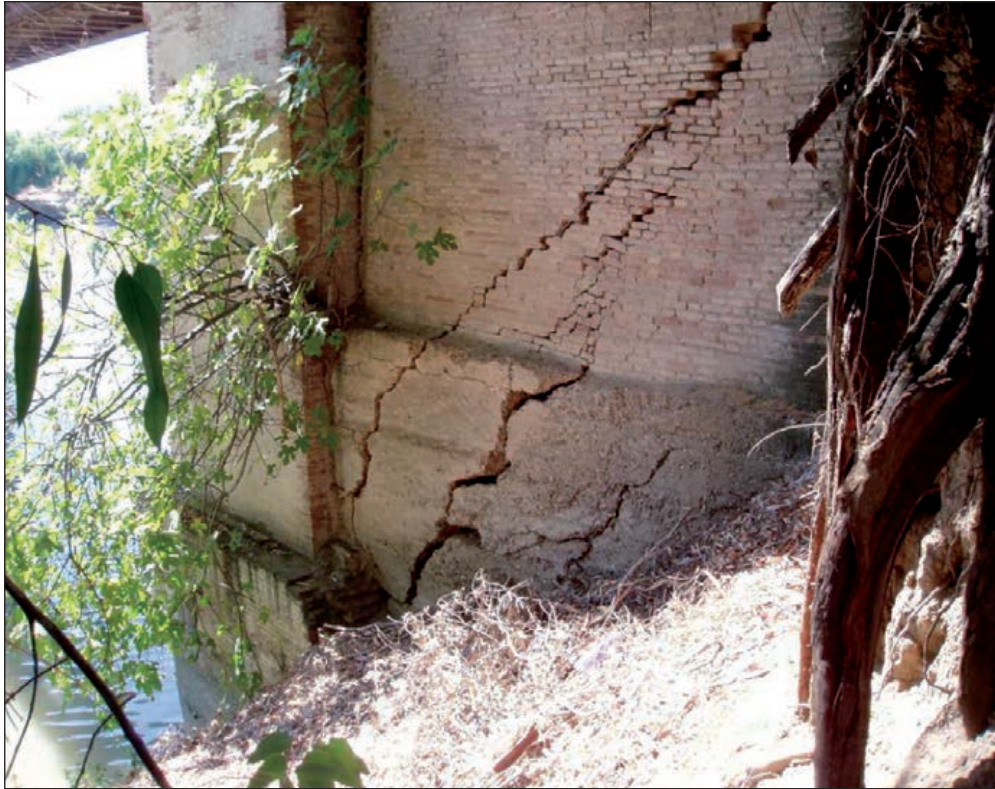
FIGURA 3.7.1. ESTRIBO «CON DAÑOS GRAVES».
