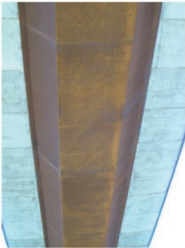
Det. 8. Corrosión en chapas.
