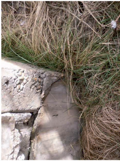
Fot1 Fisuras/Grietas en dintel cargadero Lib.8
