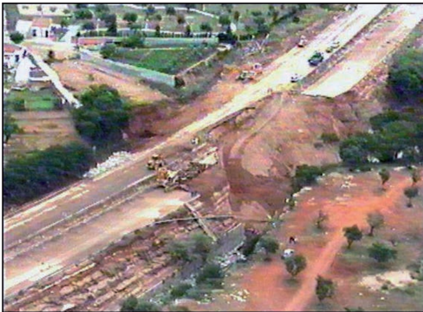
FIGURA 2.14.1. PROTECCIÓN DE LA MARGEN EN MALAS CONDICIONES (DAÑOS GRAVES).
