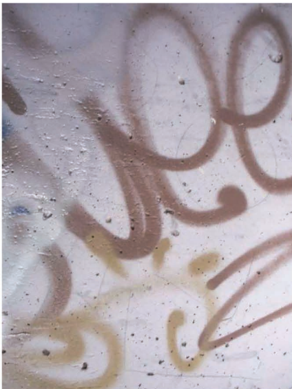
Fot3 Degradación superficial Lib.2
