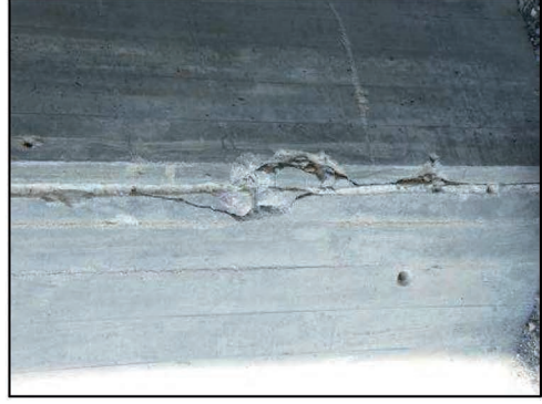
Fot.12. Desconchón sin armadura implicada (lib.1)
