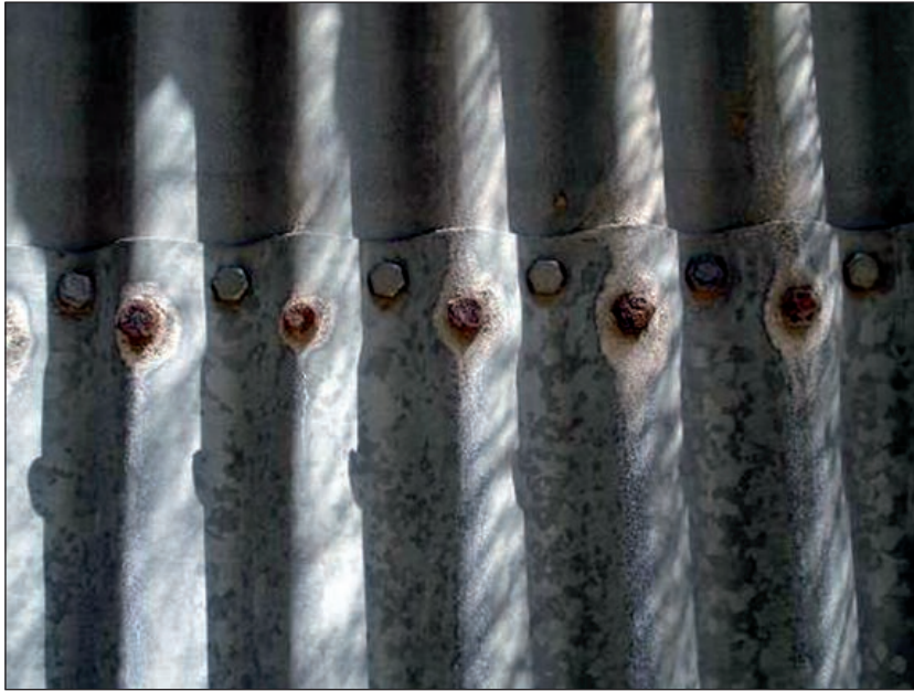
FIGURA 199. CORROSIÓN DE TORNILLOS EN UNIÓN DE CHAPAS DE UN TUBO METÁLICO.
