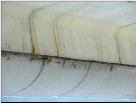
Fot.2. Humedades y filtraciones (lib. 5) en vigas
