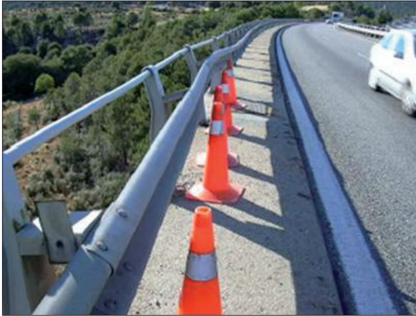
FIGURA 275. ABOLLADURA Y DEFORMACIÓN DEL SISTEMA DE CONTENCIÓN.
