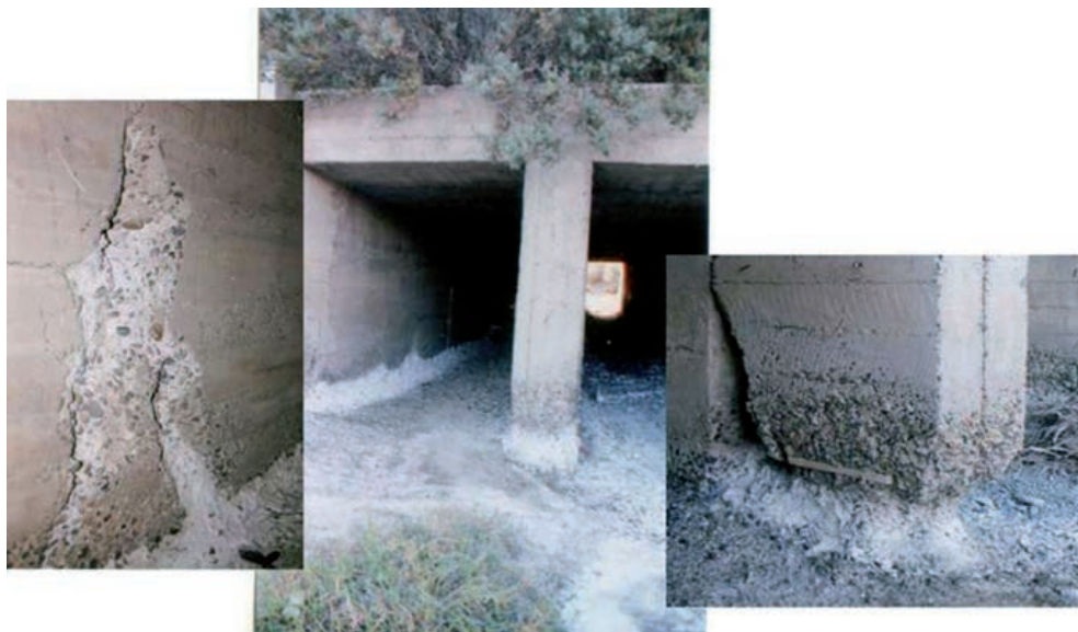
FIGURA 295. DETALLE DE LA DEGRADACIÓN DEL HORMIGÓN POR EFECTO DE CRISTALIZACIÓN DE SALES, DEBIDO A LA ROTURA DE UNA ALCANTARILLA.
