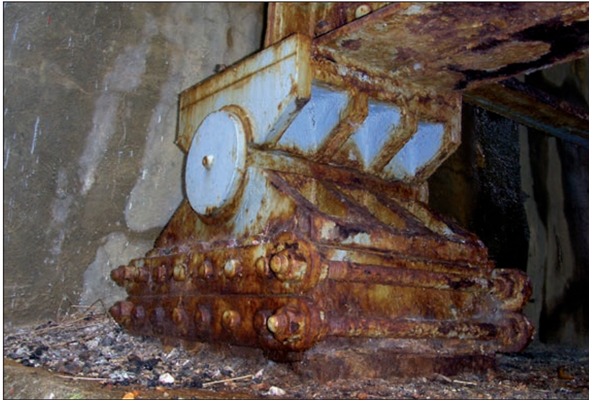
FIGURA 228. DEGRADACIÓN MUY AVANZADA DE UN APOYO METÁLICO DEBIDA A LA CORROSIÓN.
