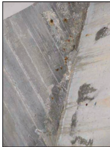
Fot. 4. Falta de recubrimiento y desconchón (lib.6)
