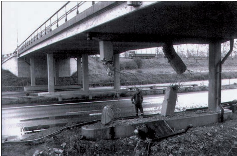
FIGURA 131. ROTURA DE DOS FUSTES DE UNA PILA DEBIDO AL IMPACTO DE UN VEHÍCULO.
