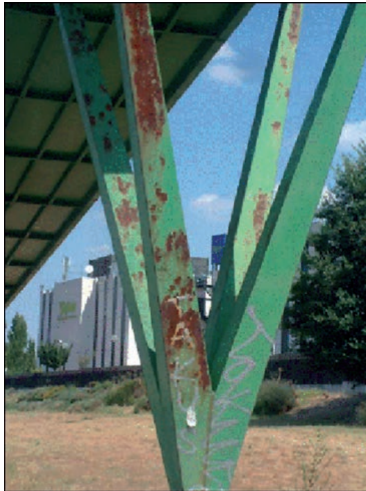
FIGURA 355. CORROSIÓN EN LAS PILAS METÁLICAS DE UNA PASARELA.
