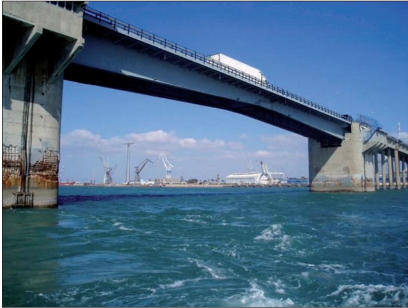
FIGURA 21. PUEBTE SOBRE LA BAHÍA DE CÁDIZ EN LA N-443, ANTES DE SER REHABILITADO.
