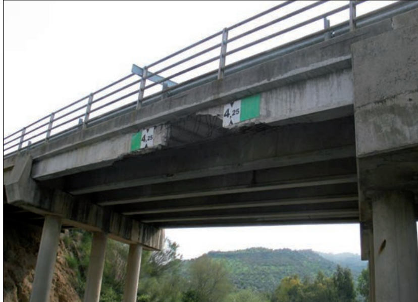
FIGURA 342. ROTURA DE UNA VIGA DEBIDO AL IMPACTO DE UN VEHÍCULO.
