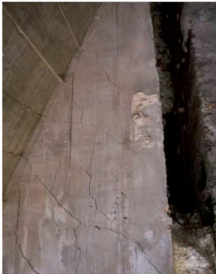
Fot3 Desconchón/Lajas con armadura Lib.4
