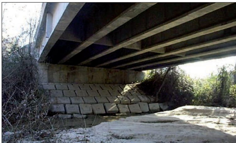
FIGURA 102. DESPLAZAMIENTO DE LOS BLOQUES DE PROTECCIÓN DE ESCOLLERA.
