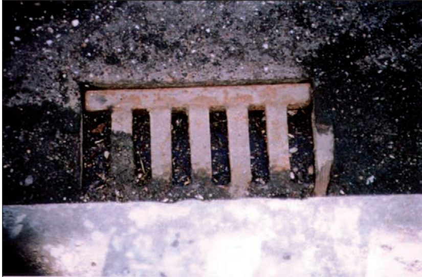
FIGURA 270. OBSTRUCCIÓN DE SUMIDERO.
