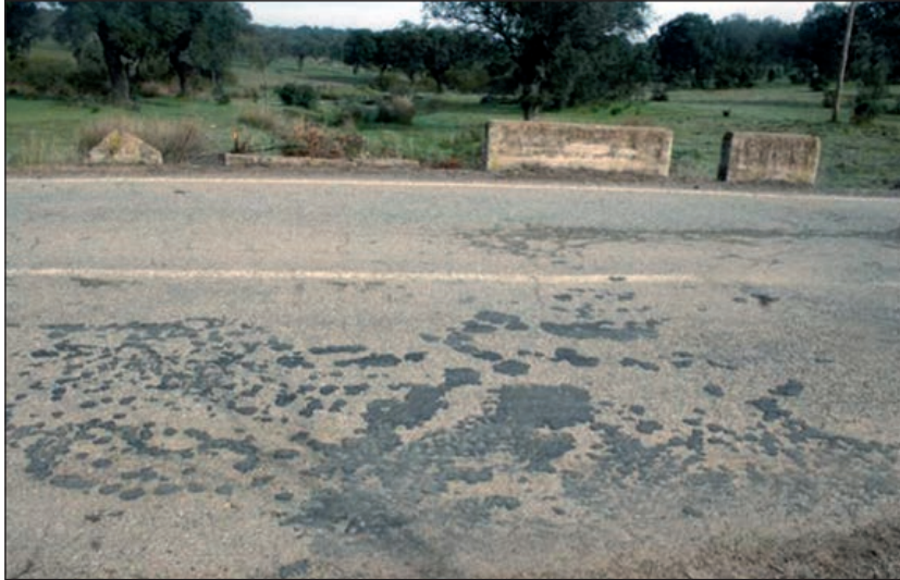
FIGURA 266. EXUDACIÓN DEL LIGANTE BITUMINOSO EN PAVIMENTO ASFÁLTICO.
