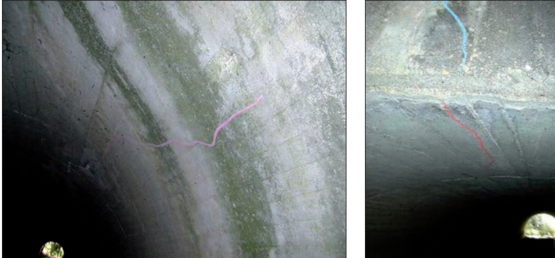
FIGURAS 192 Y 193. FISURAS POR FORMACIÓN DE RÓTULAS EN BÓVEDA DE HORMIGÓN.
