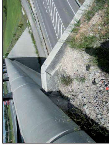
Fot. 6. Falta de relleno en trasdós de muro lat. (lib.1)
