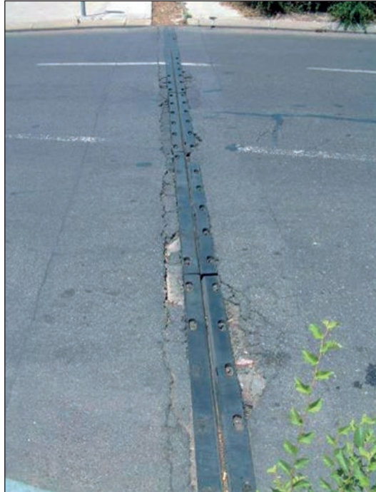
FIGURA 255. FALTA DE ELEMENTOS DE ANCLAJE DE LA JUNTA
