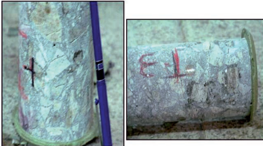
FIGURA 303. ASPECTO DE UNA PROBETA TOMADA DE UNA ESTRUCTURA CON DAÑOS POR FORMACIÓN DE ETTRINGITA.
