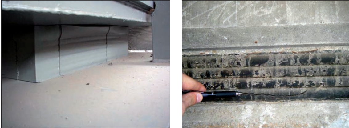
FIGURAS 236 Y 237. ROTURA DE APARATO DE APOYO.
