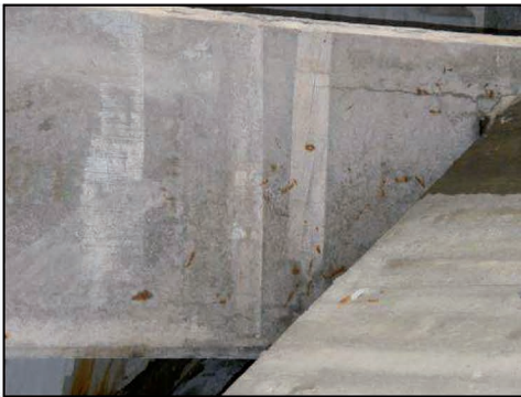
Fot 1. Falta/escasez de recubrimiento (lib.1)
