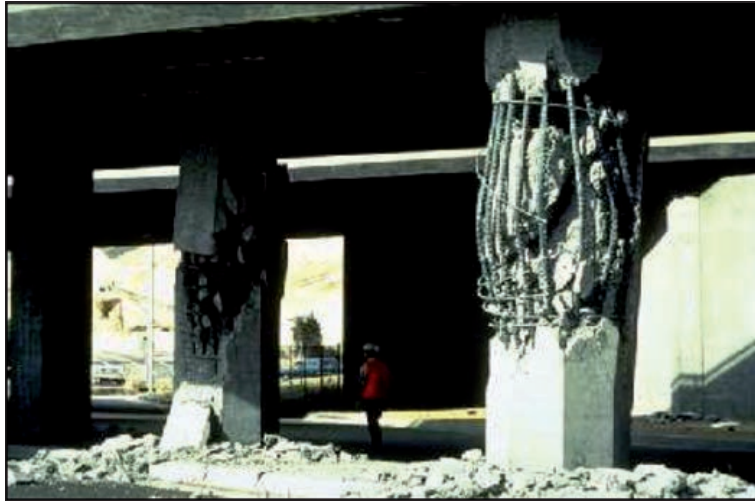
FIGURA 4.7.1. PILA «CON DAÑOS GRAVES».
