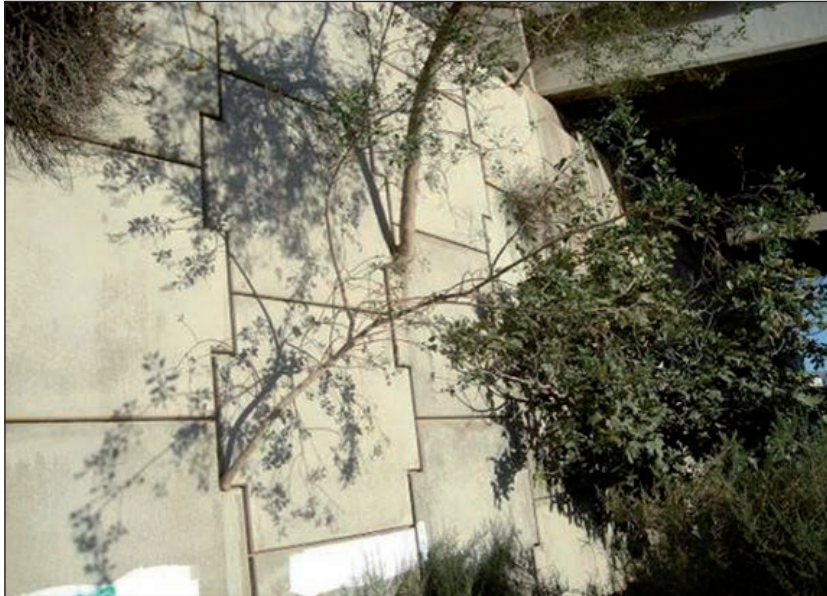
FIGURA 310. VEGETACIÓN ENRAIZADA ENTRE LAS ESCAMAS DE UN ESTRIBO DE TIERRA REFORZADA O ARMADA.
