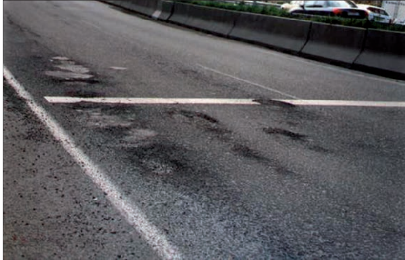
FIGURA 263. BACHES EN FORMA DE «CAZUELA» EN PAVIMENTO ASFÁLTICO.
