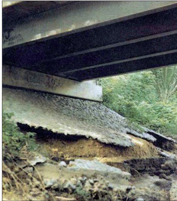
FIGURA 101. EROSIÓN Y DESLIZAMIENTOS EN EL TERRAPLÉN.
