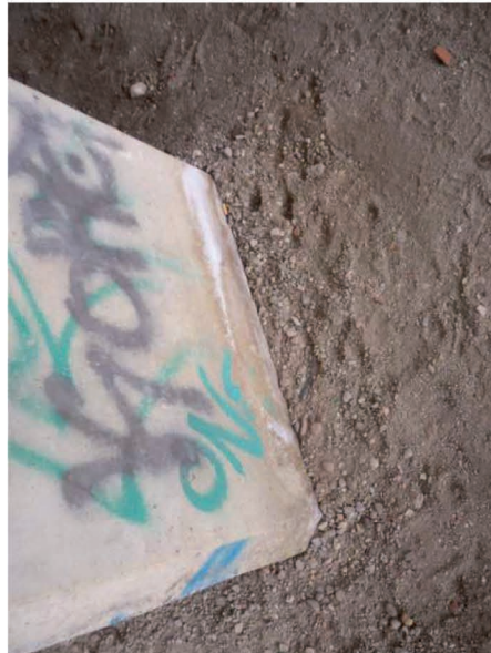
Fot5 Efflorescencias Lib1
