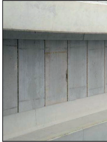
Fot. 5. Desconchón sin armadura implicada (lib.1)
