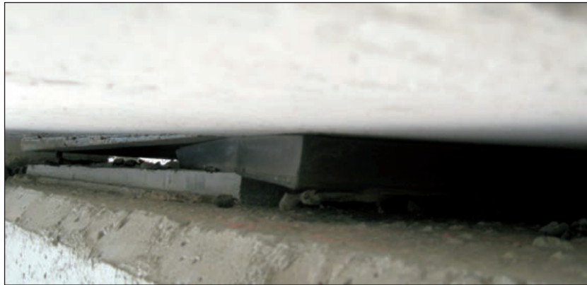
FIGURAS 230 Y 231. PÉRDIDA DE LA POSICIÓN ORIGINAL DEL APARATO DE APOYO.
