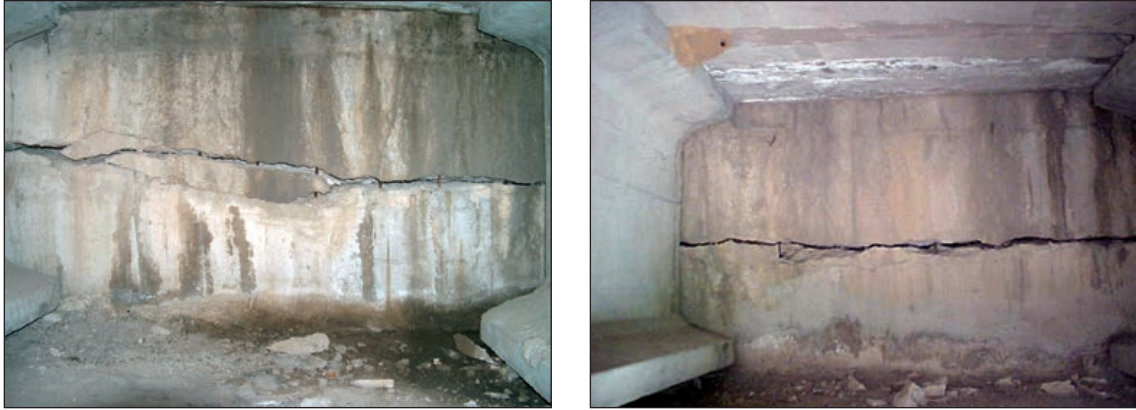
FIGURAS 116 Y 117. GRIETAS EN MURETE DE GUARDA POR EMPUJE DE TABLERO (GIRO-HUNDIMIENTO DE LA LOSA DE TRANSICIÓN) O TERRAPLÉN TRASDOSADO.
