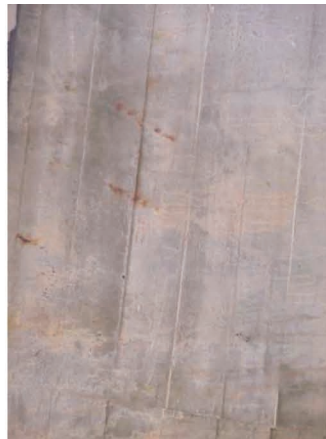
Fot8 Fisuras/Grietas Lib.16
