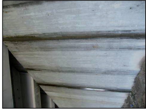
Fot.11. Humedad en M.Frontal a través de juntas (lib.1)
