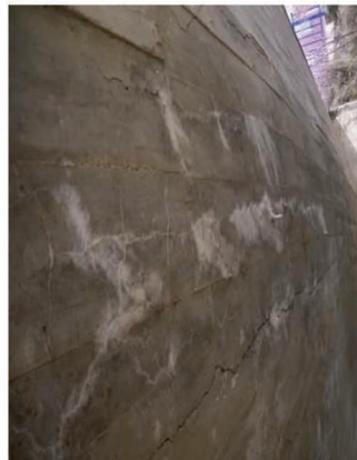
Fot7 Eflorescencias Lib1
