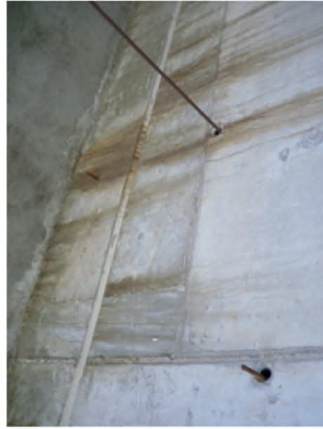
Det. 1 Encofrado sin retirar
