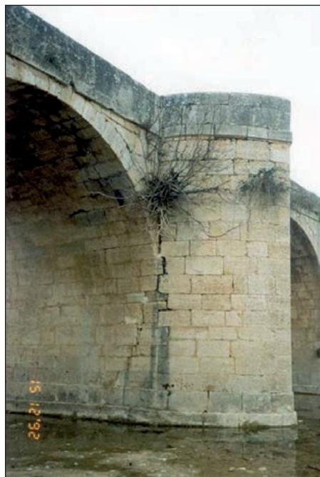
FIGURA 352. VEGETACIÓN ENRAIZADA EN EL TAJAMAR DE UNA PILA.
