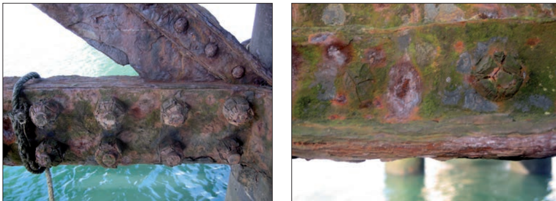
FIGURAS 363 Y 364. UNIONES ROBLONADAS Y ATORNILLADAS (IZQUIERDA) Y DETALLE DE CORROSIÓN DE ROBLONES (DERECHA).
