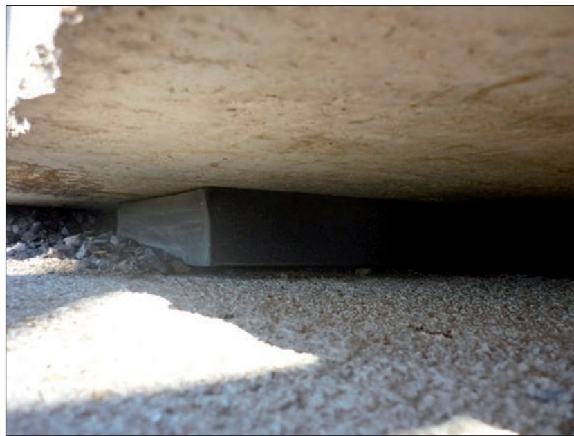
FIGURA 240. AUSENCIA DE CAMA DE NIVELACIÓN.
