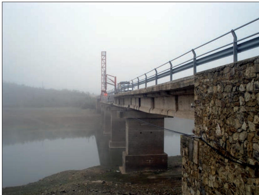
FIGURA 134. DEFORMACIÓN DE LAS VIGAS.
