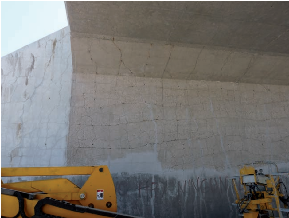
FIGURA 50. PARAMENTO DE HORMIGÓN PARCIALMENTE CHORREADO (PARTE SUPERIOR DEL HASTIAL Y DINTEL). SE PUEDEN APRECIAR LAS GRIETAS QUE ERAN INVISIBLES ANTES DEL TRATAMIENTO DE LIMPIEZA.
