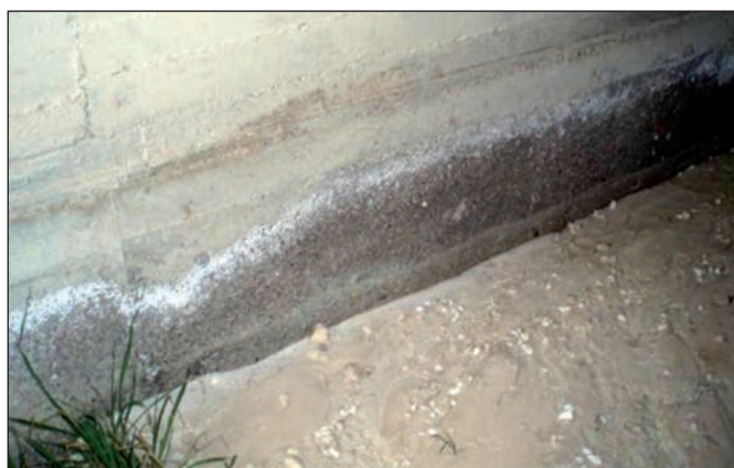
FIGURA 346. HUMEDADES POR CAPILARIDAD EN ESTRIBO.
