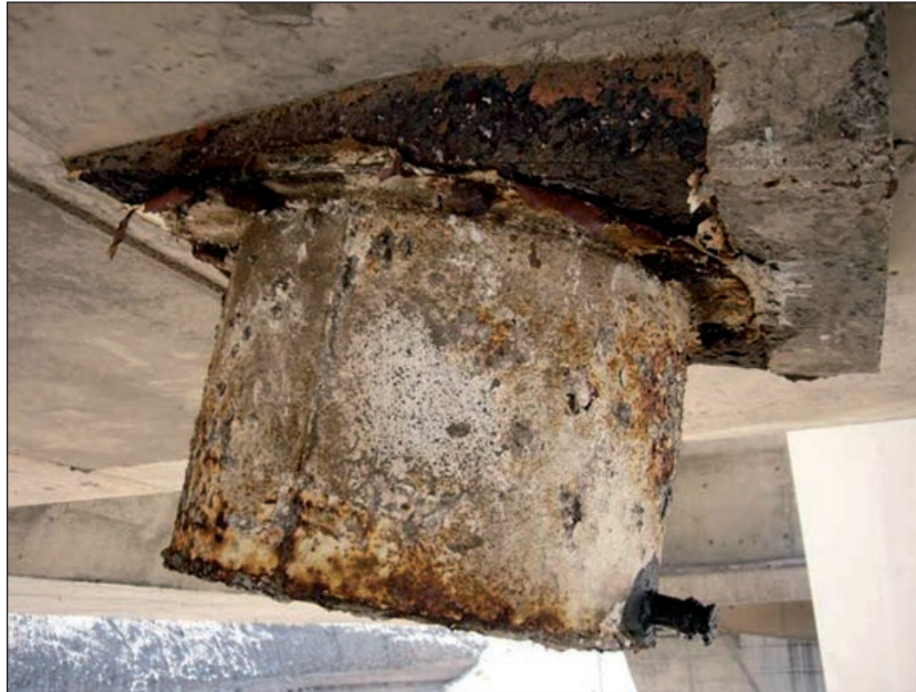
FIGURA 217. CORROSIÓN EN EL EXTERIOR DEL CAPOT.
