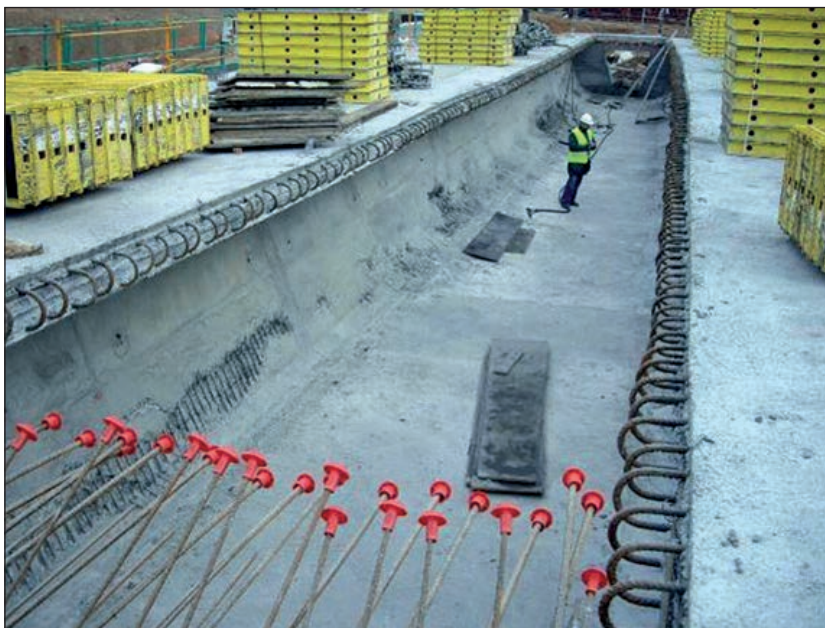
FIGURA 158. INCORRECTA EJECUCIÓN DEL HORMIGONADO DE UN CAJÓN. LA ELEVADA CONCENTRACIÓN DE ARMADURA DIFICULTA UN VIBRADO ADECUADO, PERO TAMBIÉN UN HORMIGÓN CON UNA CONSISTENCIA INADECUADA O UNA MALA COMPACTACIÓN.
