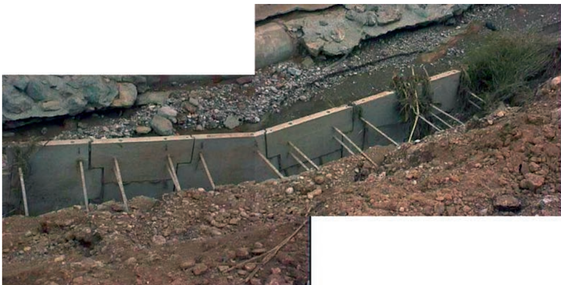
FIGURA 2.14.2. PROTECCIÓN DE LA MARGEN EN MALAS CONDICIONES (DAÑOS GRAVES).
