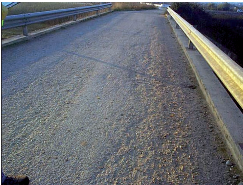
FIGURA 262. DESGASTE EXCESIVO DEL PAVIMENTO ASFÁLTICO.
