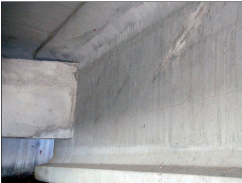
FIGURA 140. FISURAS POR CORTANTE EN VIGA DOBLE T.
