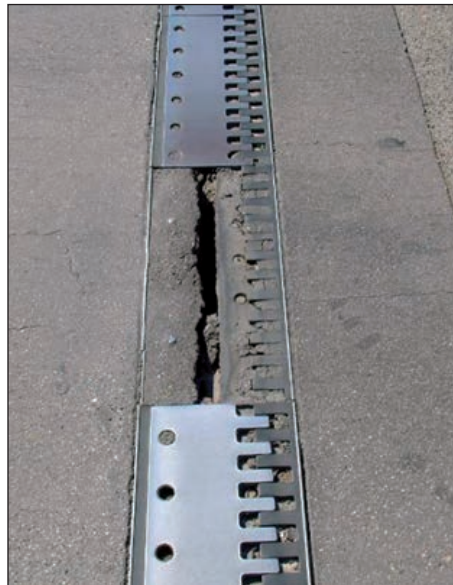
FIGURA 249. AUSENCIA DE UNO DE LOS MÓDULOS DE LA JUNTA TIPO PEINE.
