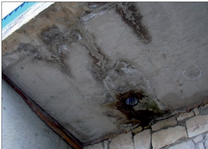
FIGURA 269. AUSENCIA DE LOS DISPOSITIVOS DE DRENAJE ADECUADOS (GOTERÓN Y TUBOS DE DESAGÜE PARA EVITAR QUE EL AGUA DISCURRA POR LOS PARAMENTOS DE LA ESTRUCTURA).
