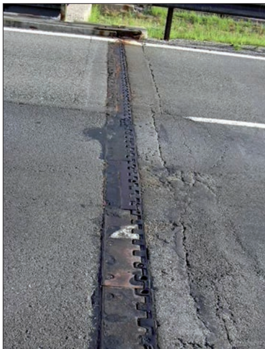
FIGURA 256. CORROSIÓN DE MÓDULOS METÁLICOS DE UNA JUNTA TIPO PEINE.
