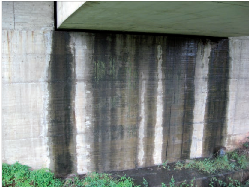
FIGURA 251. LA FALTA DE ESTANQUEIDAD DE LAS JUNTAS DE CALZADA PUEDE COMPROBARSE FÁCILMENTE OBSERVANDO LA EXISTENCIA DE HUMEDADES Y FILTRACIONES EN LA SUBESTRUCTURA.
