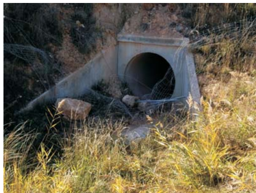
Figura 4.29. Un ejemplo de mantenimiento deficiente del cerramiento perimetral: parte del vallado se ha caído y dificulta el acceso a una estructura transversal. Fotos: TEG-UAM.
