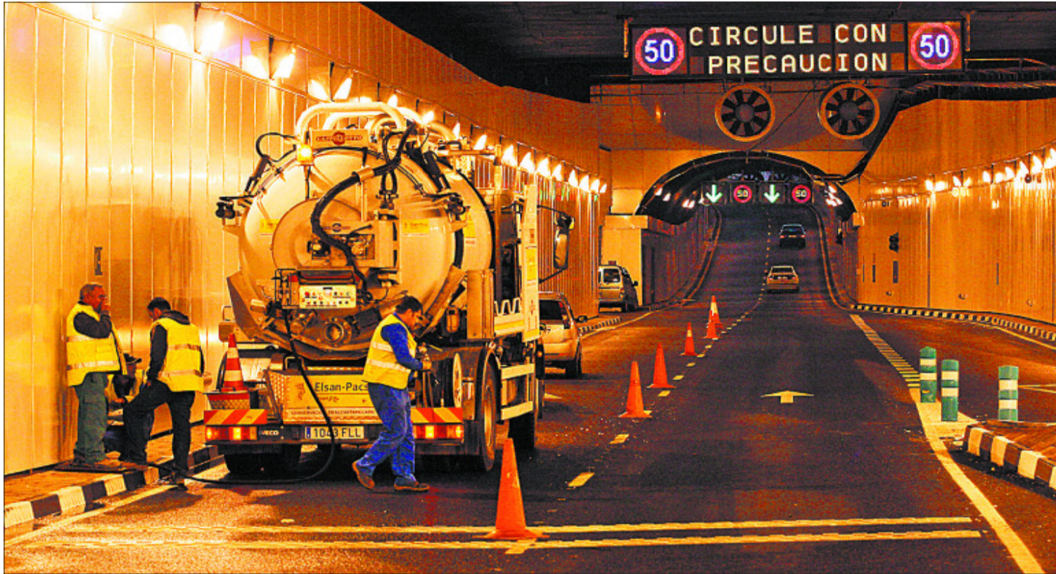
Varios operarios achican el agua con un camión bomba en el túnel de Ventisquero de la Condesa, que también sufrió inundaciones. / CLAUDIO ÁLVAREZ
