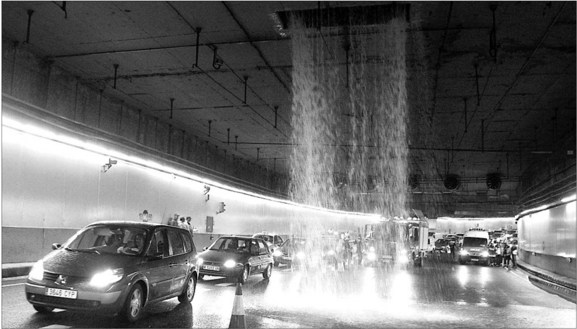
Los coches pasan junto a la cascada de agua en el túnel de la M-30. / CLAUDIO ÁLVAREZ
